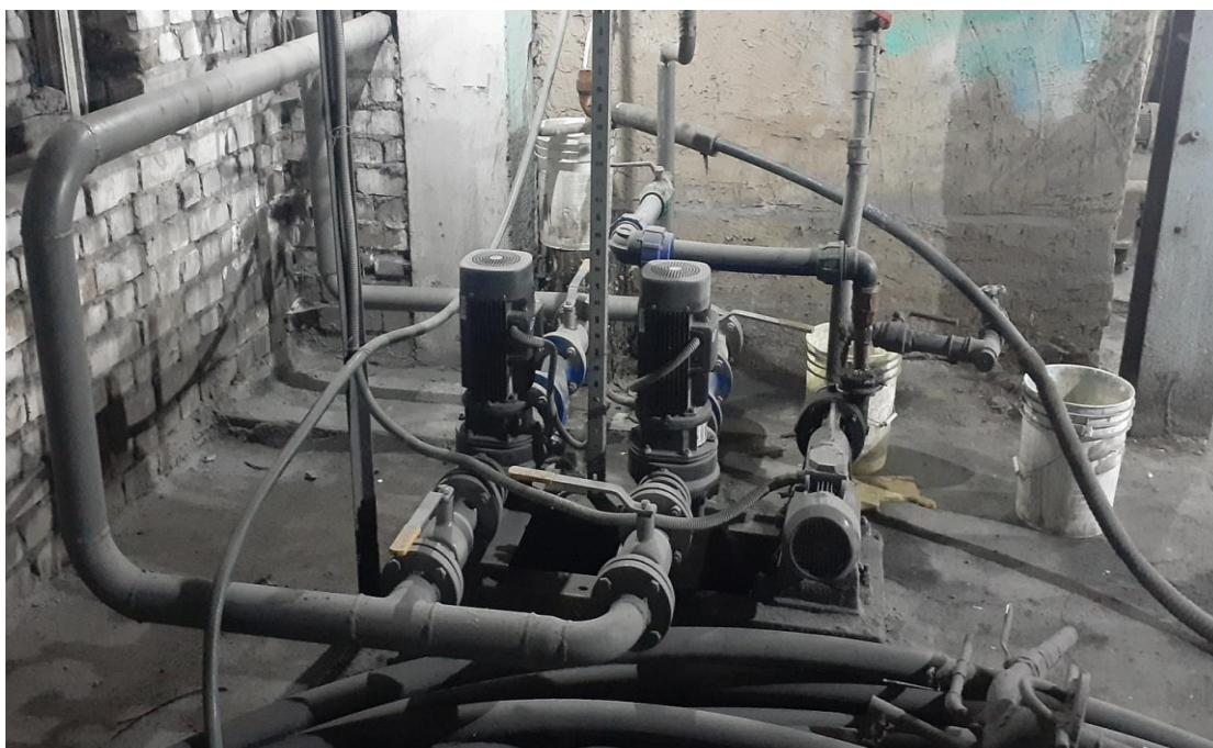
Рис.4. Насосная группа котельной
