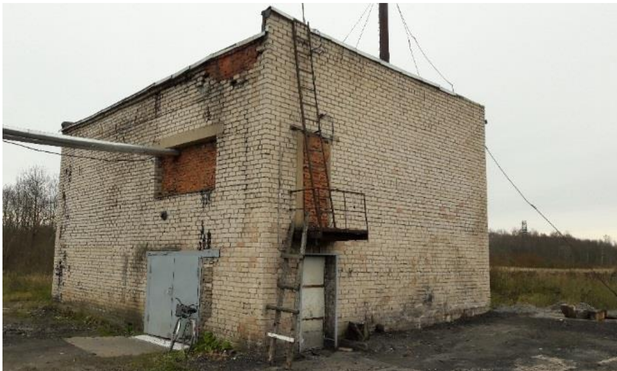
Рис.1. Внешний вид котельной
