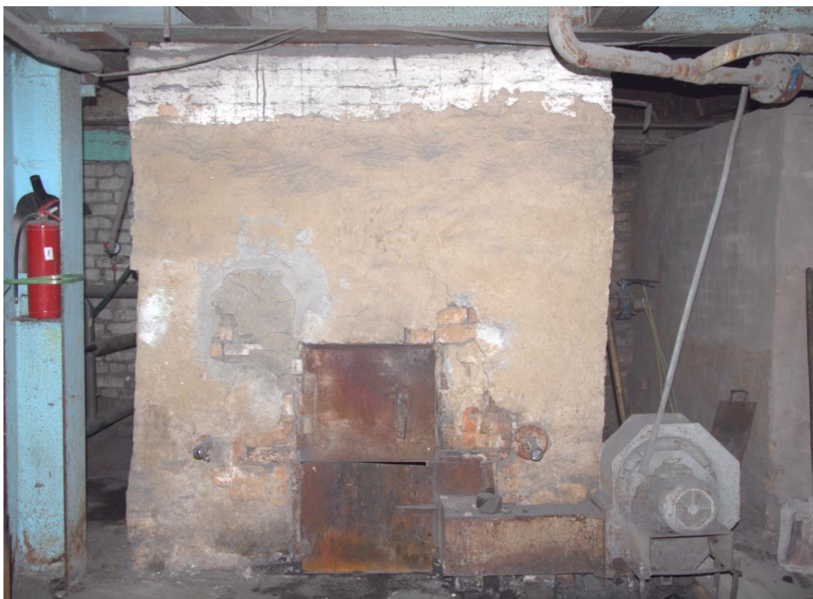
Рис.3. Внешний вид котлоагрегата КВ
